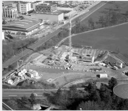
Baustelle «Holzlogistik» HHKW Aubrugg AG. Links im Bild der Durchstich unter der Autobahn für die Transportförderbänder. Bildmitte, Abwurfbunker für die Hackschnitzel.
