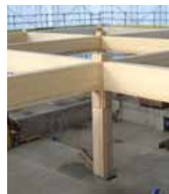
Die Träger sind aus Esche und Fichte zusammengesetzt, um die Festigkeit zu erhöhen.
