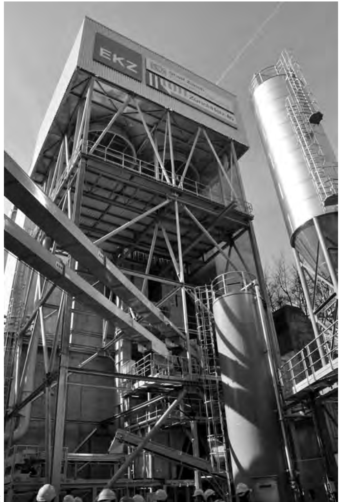
Zwei Förderbänder (mitte links) führen die Holzsplitzel vom Holzlogistikstandort zur Anlage des HHKW. Zu sehen sind auch der Silo des für die Wirbelschichtfeuerung benötigten Quarzsandes (unten mitte) und der Aschesilo (rechts).
