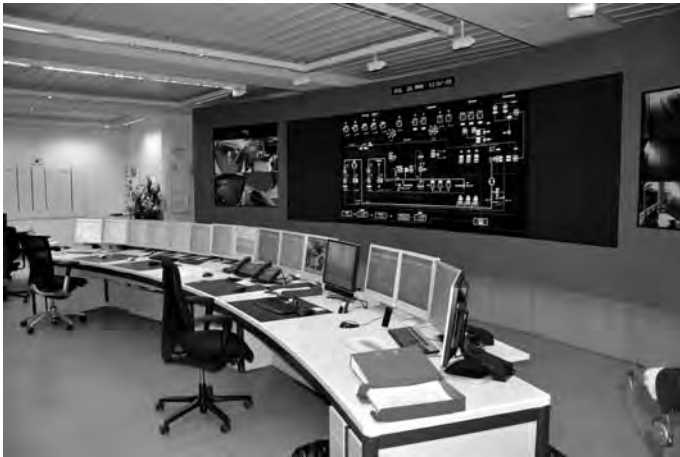
Das HHKW Aubrugg verfügt über modernste Steuerungstechnik.
