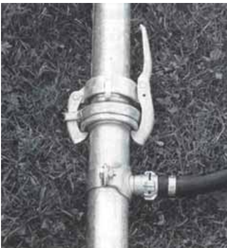
Abbildung 2: Transportleitung aus Schnellkupplungsrohren, mit Abzweigung einer Schlauchleitung
