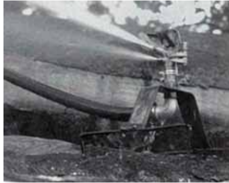
Abbildung 3: Auf Holzpolter angebrachter Sprinklerbock, mit Schlauchleitungsanschluss und aufgeschraubtem Sprinkler
